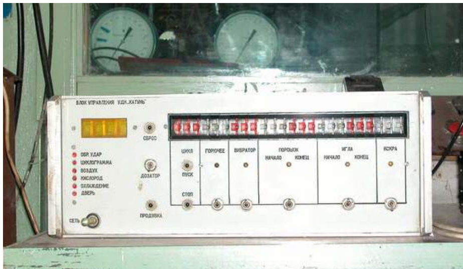
Рисунок 2.4 - Блок управления установки ДГН «Катунь М»
