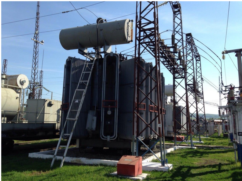
Рисунок 4.2 – Силовой трансформатор тяговой подстанции 110 кВ
