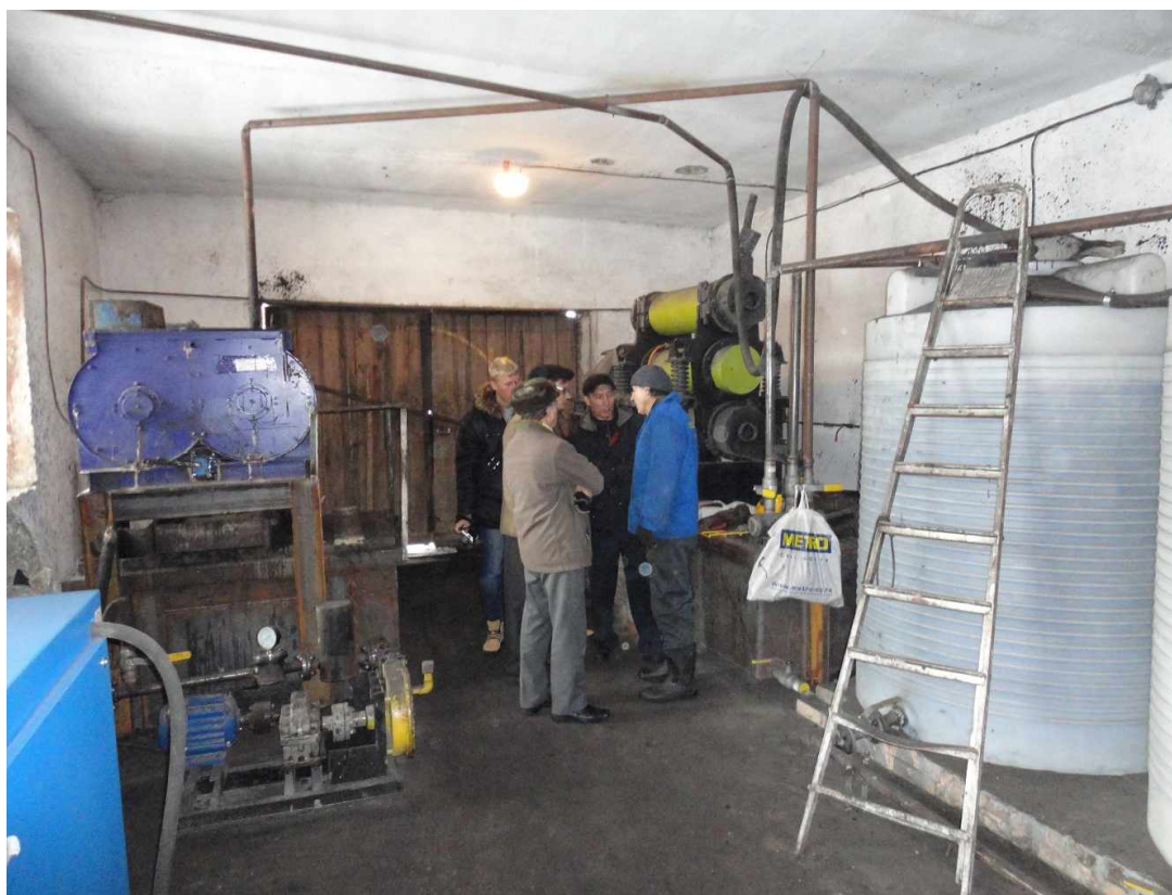
Рисунок 4.17 – Общий вид установки приготовления и сжигания ВУТ
