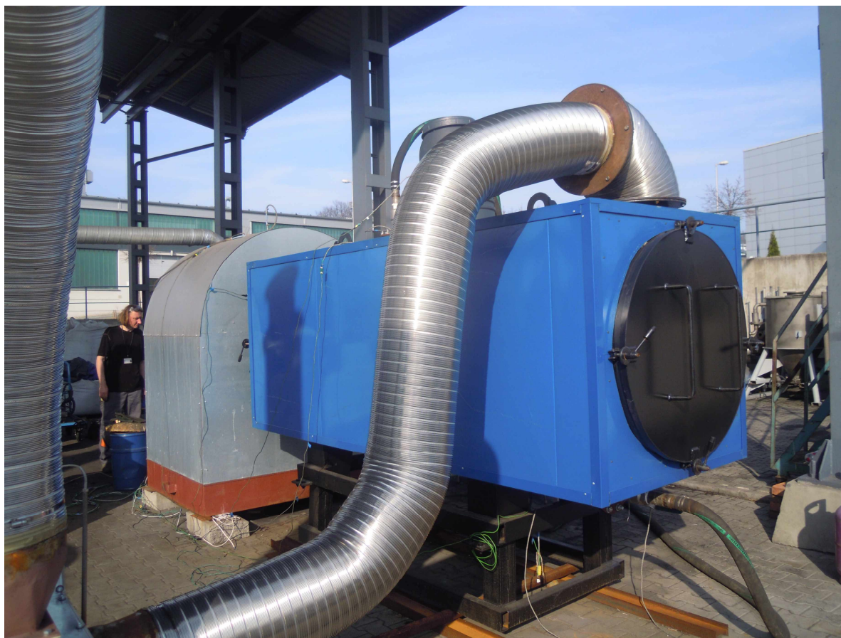
Рисунок 4.10 – Установка сжигания ВУТ, г. Забже, Польша
