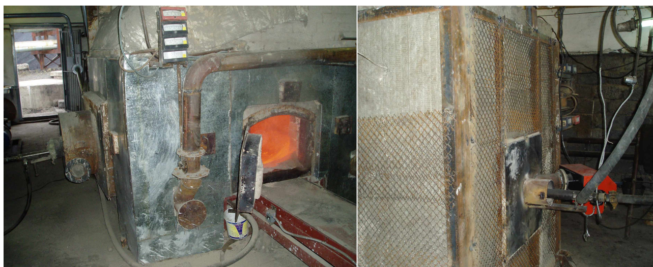
Рисунок 4.16 - Фото котла Е-1-9 с топкой ВУТ.
