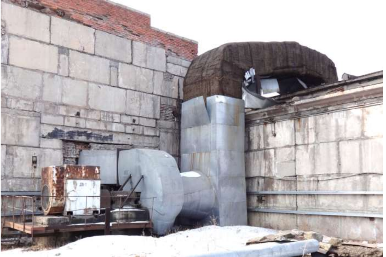
Рис. 1.13. Вентилятор для создания дутья в размораживающее устройство Владивостокской ТЭЦ-2
