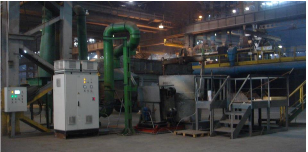
Рисунок 4.21 - Комплекс электромагнитного перемешивания установленный на ООО «КраМЗ»
