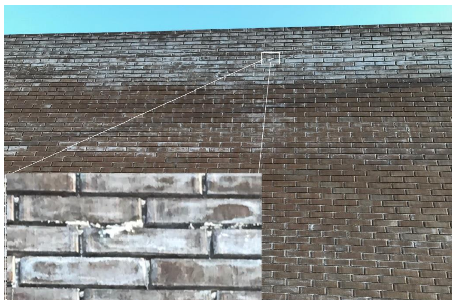
Рис. 2. Образование высолов между рядами кирпичной кладки
